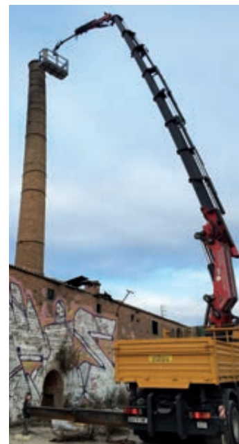
La chimenea será reforzada
