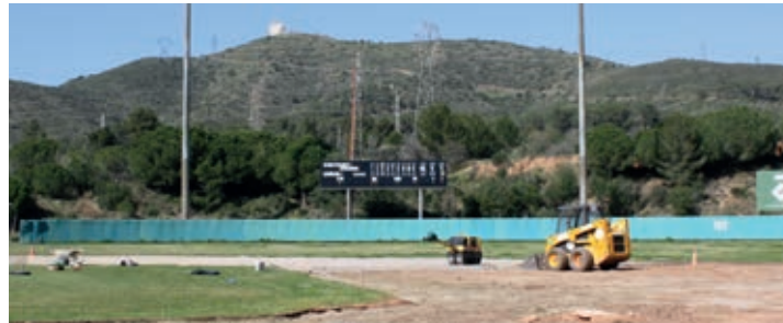
La tierra batida había perdido capacidad de filtración
