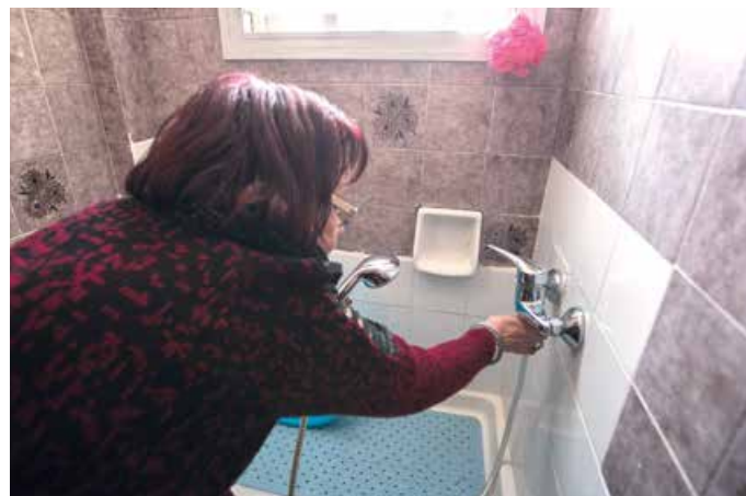
Juana ha instalado un reductor de caudal en la ducha tras la visita
