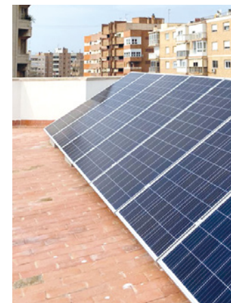
Panells solars en una coberta
